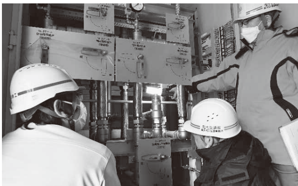
写真-7 空気制御盤確認状況
