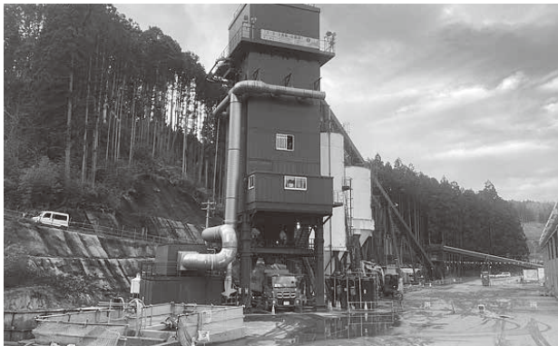
写真-2 バッチャープラント
